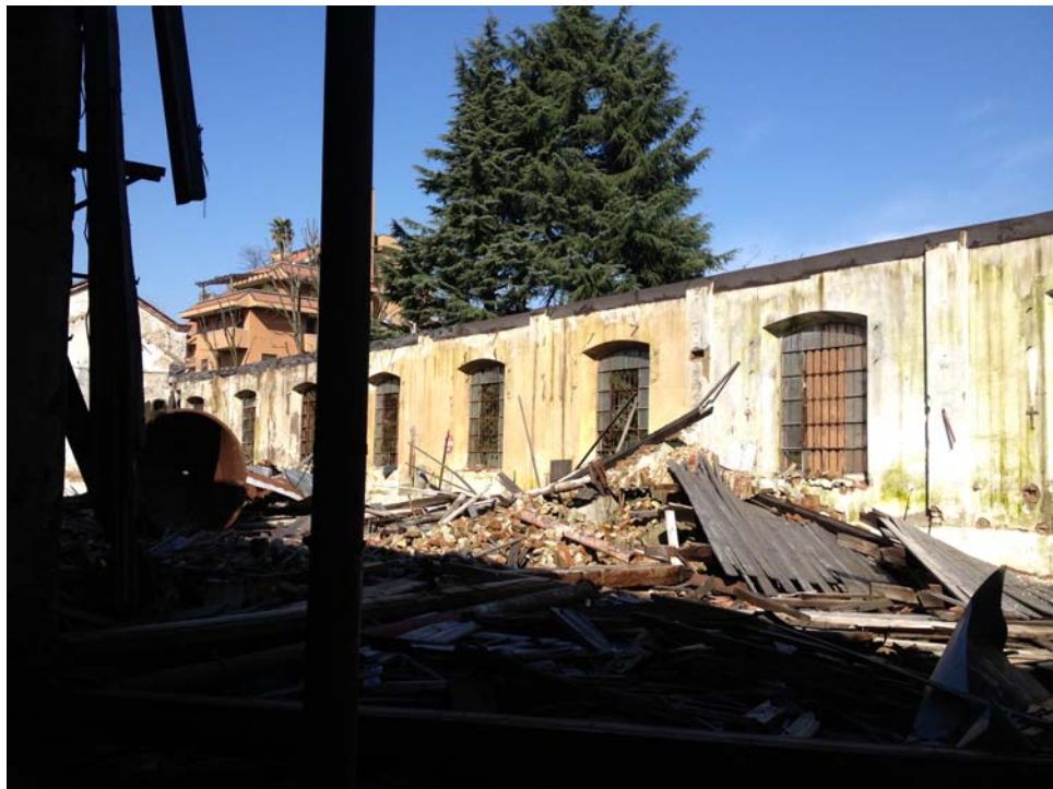
Foto 11- capannoni crollati-vista interna del muro lungo via Donizetti.
