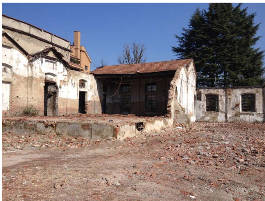
Foto 12-STATO ATTUALE- capannoni crollati interno lato nord/est a seguito delle demolizioni effettuate dal dicembre 2014 al febbraio 2015.
