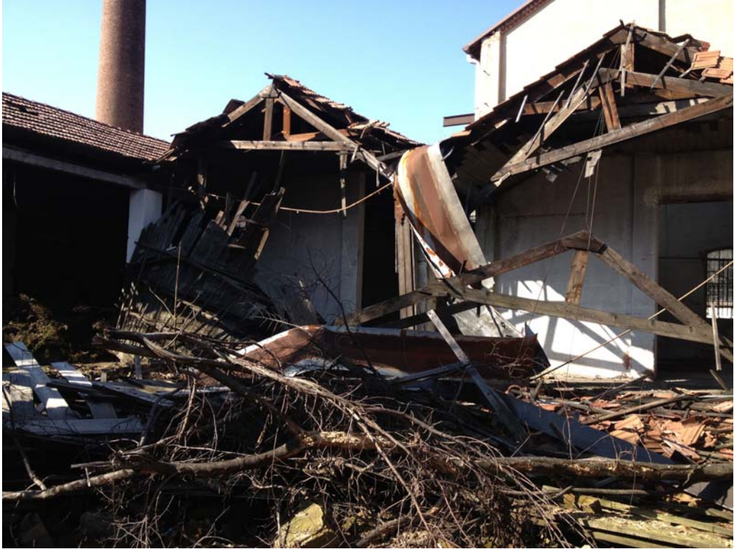
Foto 14-capannoni crollati zona nord
