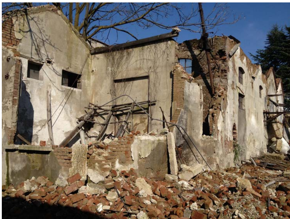
Foto 12- capannoni crollati interno lato nord/est.
