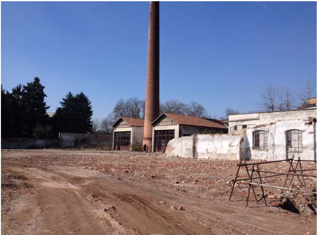
Foto 14a-capannoni crollati zona nord a seguito delle demolizioni effettuate dal dicembre 2014 al febbraio 2015.
