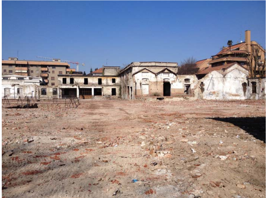
Foto 9a-STATO ATTUALE- vista della strada interna dall'accesso di viale C.Battisti 40 a seguito delle demolizioni effettuate dal dicembre 2014 al febbraio 2015.
