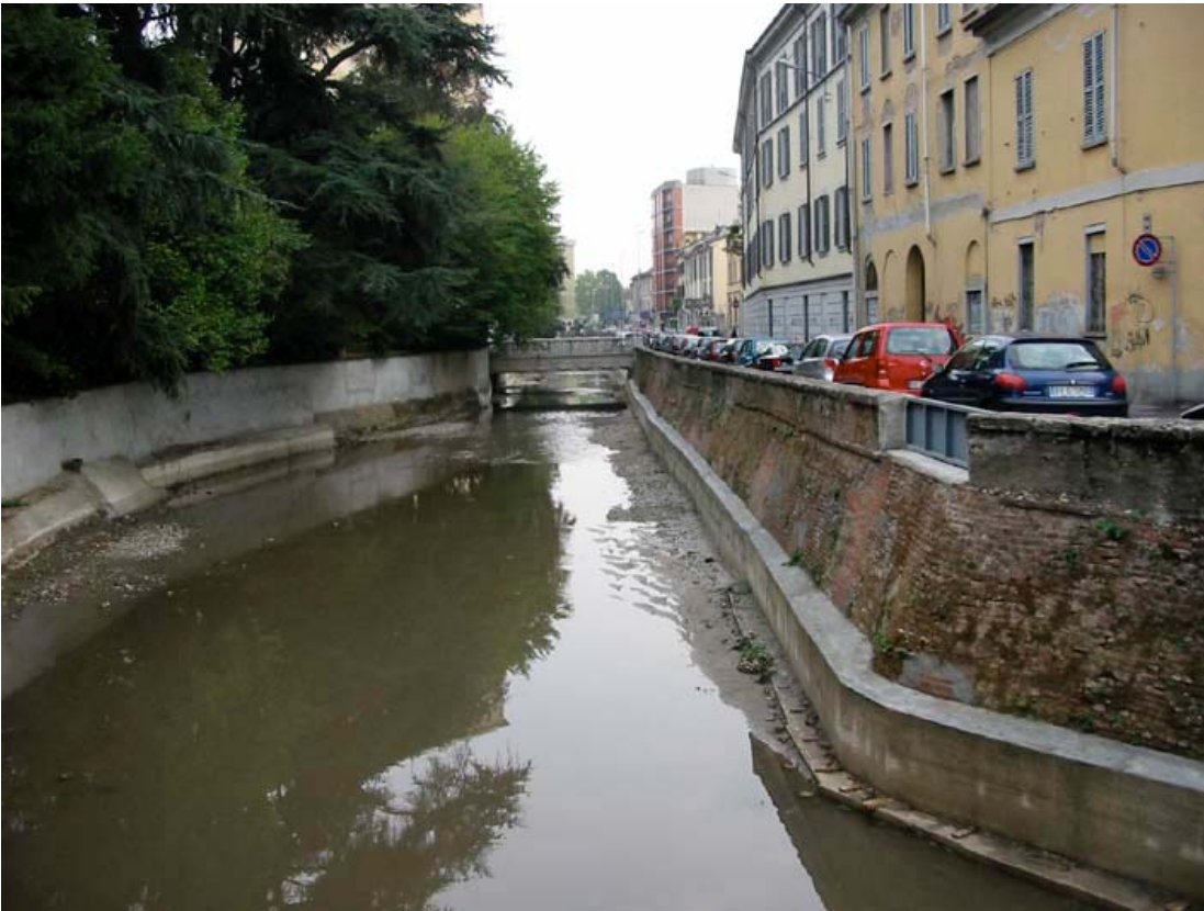
Figura 27 Rinforzi al piede dei muri di sostegno delle sponde del Lambretto (si vede la paratia mobile sul parapetto). Sullo sfondo il ponte di Via Villa
